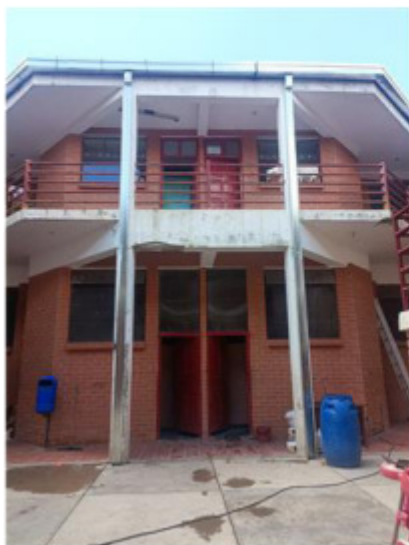
CANALETA Y BAJANTES
